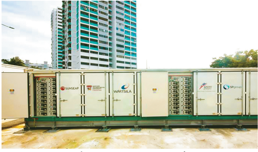
Công ty SemCorp của Singapore đang hoàn tất những công đoạn cuối cùng trong lắp đặt Hệ thống Lưu trữ Năng lượng (ESS).
